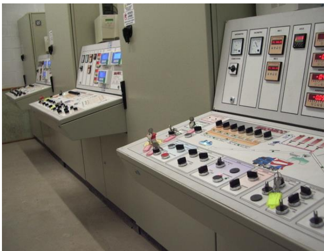
Pannelli comandi ad uso del servizio manutenzione per controllo impianto
