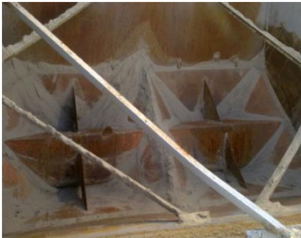
Protezioni tramogge di carico
