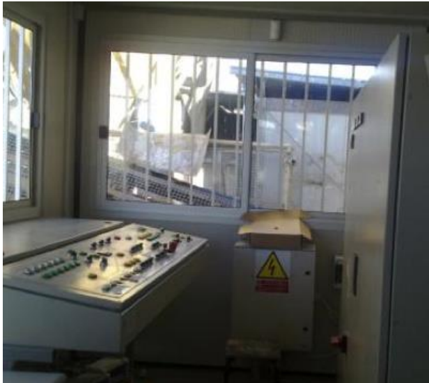
Pannelli comandi ad uso del servizio manutenzione per controllo impianto
